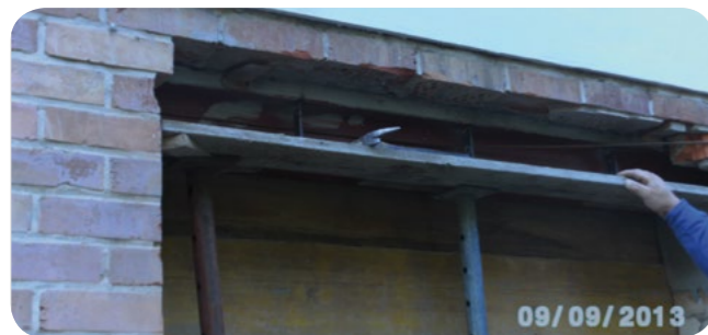
Stahlträger (neuen Terrassentür der Geschäftsstelle) und Schalung zum Einbau der Backsteine mit Klebanker
